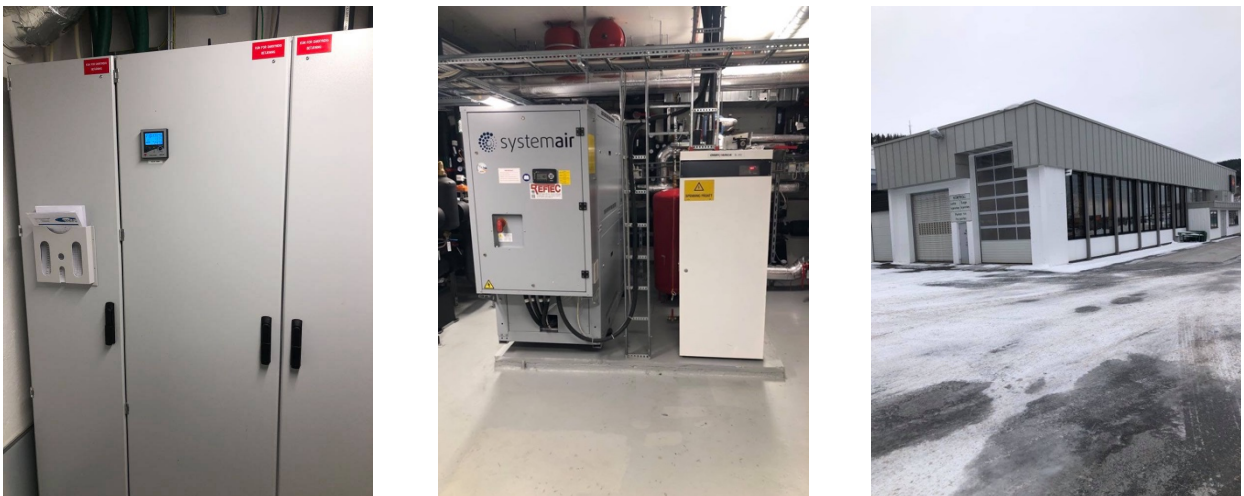
Figur 26: Illustrasjonene viser hovedtavle (t.v.), oppvarmingssystemet (t.m.) og kontrollhall (t.h.) (foto: A. A. Nysted)
