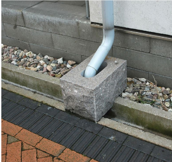
Figur 17: Nedløpsrør på Bo01(Austin, 2013).
