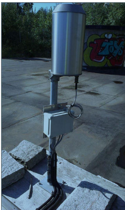
Figur 4.12 Viser nedbørmåler av type Lambrecht med vippepluviograf nedbørsensor – Kilde: Bilde er fra Haneborg høydebasseng tatt av Rosim AS
