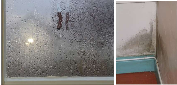
Figur 51. Bilde til venstre viser et vindu der fuktig luft kondenserer, og bildet til høyre viser muggsopp som skyldes at fuktig luft har kondensert på den kalde overflaten. (K. Gustavsen)
