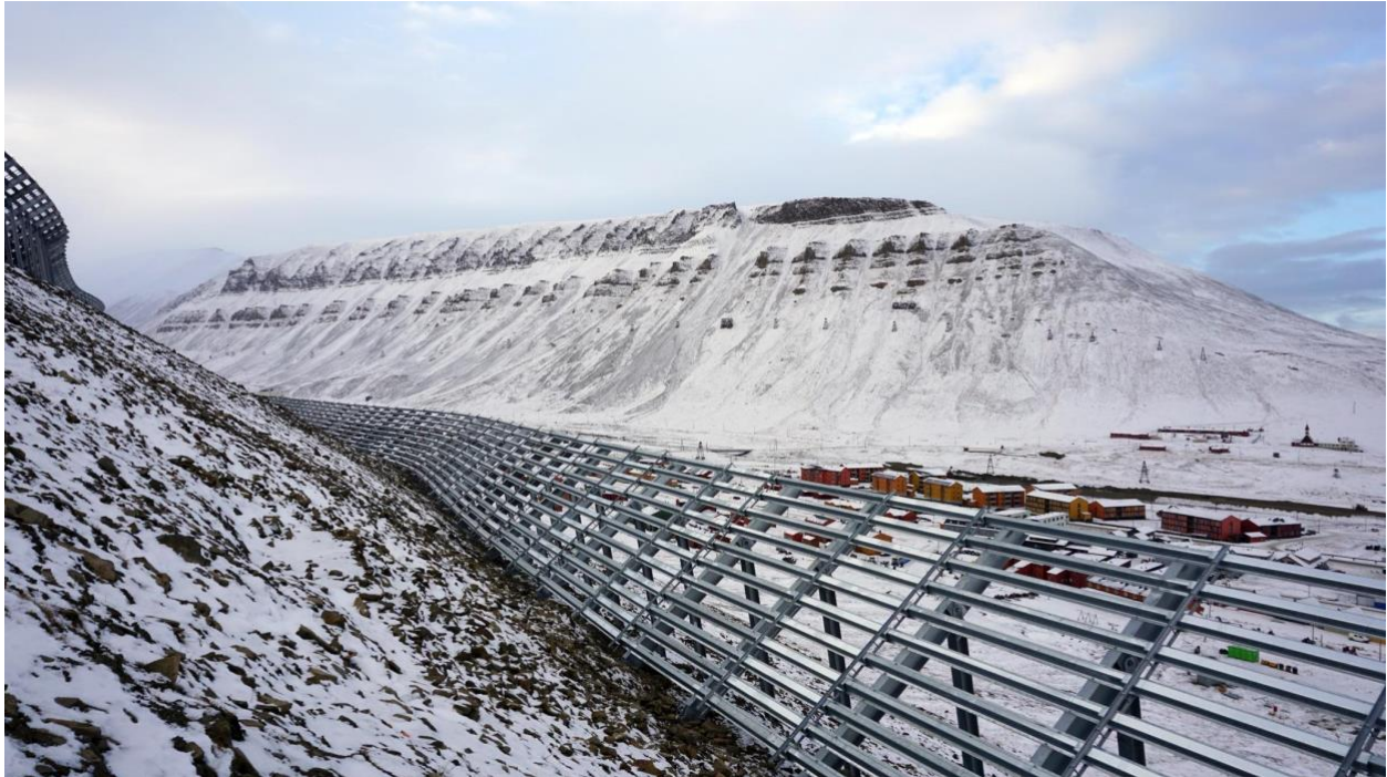
Figur 26: Støtteforbygninger på Sukkertoppen på Svalbard. Foto er hentet fra: (DS Entreprenør, 2018).
