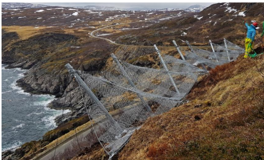
Figur 32: Stålnett på Sørøya i Finnmark. Veien mellom Sørvær og Hasvik var utsatt for steinras på sommerstid og snøskred på vinterstid. Hovednettet er supplert med et sekundærnett som har mindre maskestørrelse. Foto er hentet fra: (Geobrugg, 2019).
