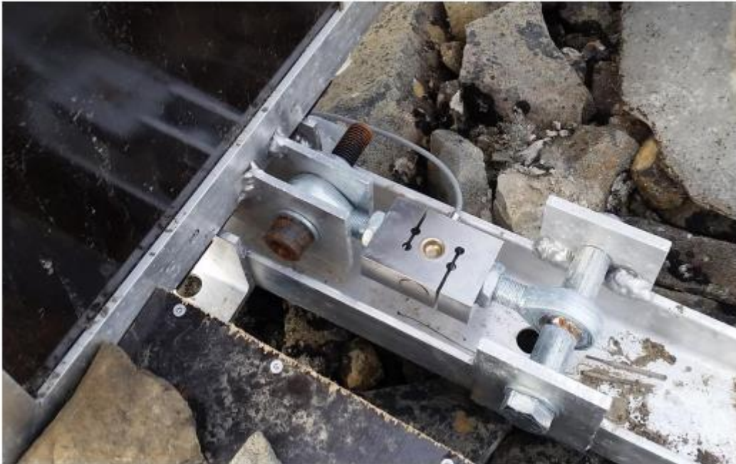
Figur 66: Figuren viser lastcellene montert med kulelagrede ledd i hver ende. Foto: Jan Are Jacobsen. Hentet fra: (Jacobsen, 2017).
