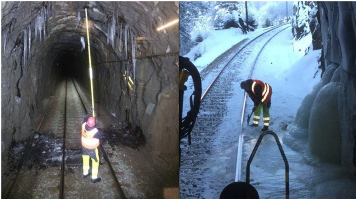
Figur 17: Fjerning av is på Bergensbanen. (Ekanger, 2019)
