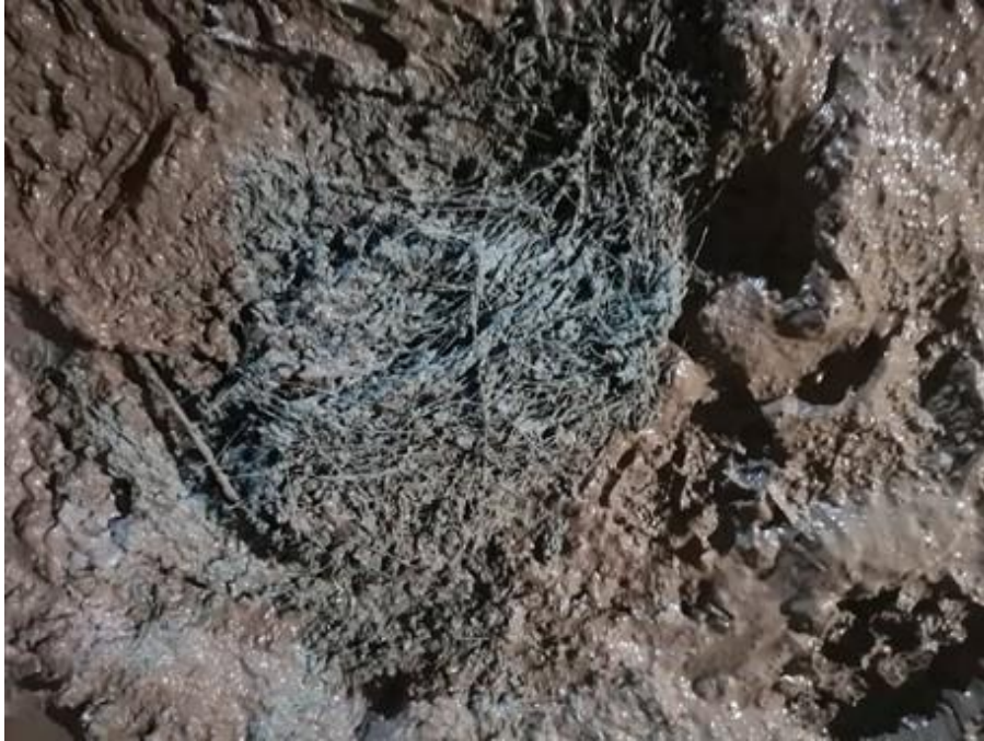
Figur 5-3: Fiberball som ble fjernet fra betongmottak.
