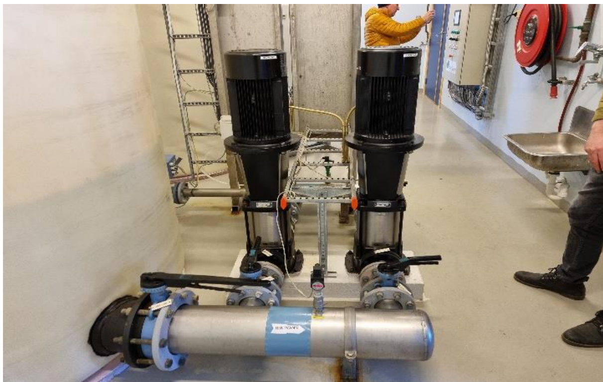
Figur 8: Bildet viser eksisterende pumper ved vannbehandlingsanlegget på Husøy.
