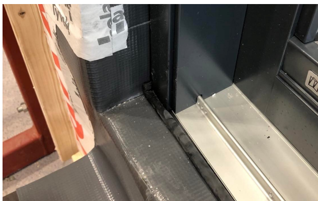
Figur 3.28: Skyvedør falt ned på og klemte tettelist under innheising.
