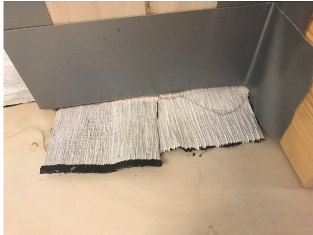
Figur 4.17: Lekkasje under kortsiden av boks under prøving av FlexTett mot kryssfinér.
