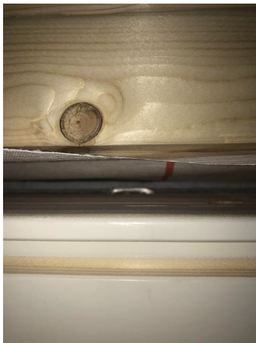
Figur 4.10: Vann presses inn gjennom butylen i Forsøk 3.
