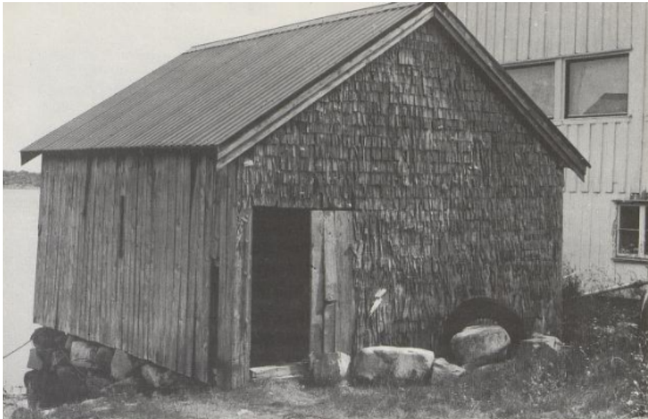
Sjøbu på Ekkilsøy med sponkledd værvegg. Utslitt sponkledning virker uanselig og uinteressant. Denne sponveggen står nok ikke til å redde, den er ubønhørlig utslitt av været fra sørvest. Men spontekkingen kan fornyes. Da er ferdigheter og materialkunnskap nødvendig. Bordveggen bak sponene er i god stand – spontekkingen har tjent sin funksjon. Sponlengden er 32–33 cm, mens rasthøyden er 13–14 cm. Der annet ikke er nevnt, er fotografiene tatt av forfatteren, og de inngår i Håndverksregisterets dokumentasjonsarkiv.
