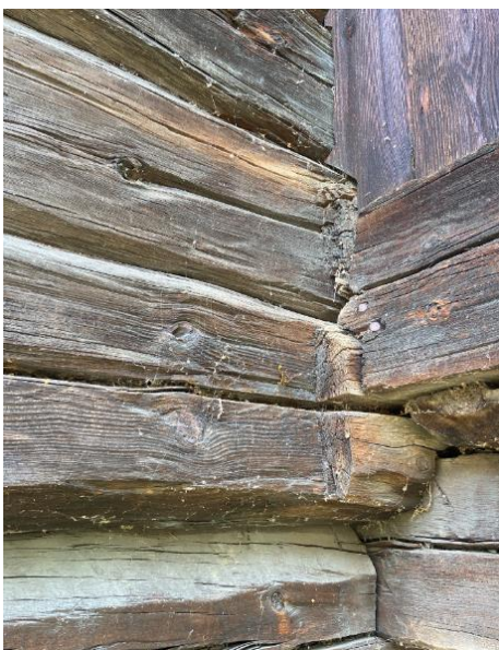
10. Spor i bygget syner at det er telgd etter oppføring. (Foto: Aabol)
