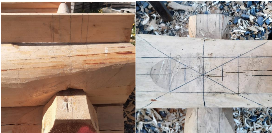
50 og 51. Oppmåling og merking av opplft før hogging, merka etter faste mål på malen eg bruka på flatinga på ryggen (Foto:Høgnes.)
