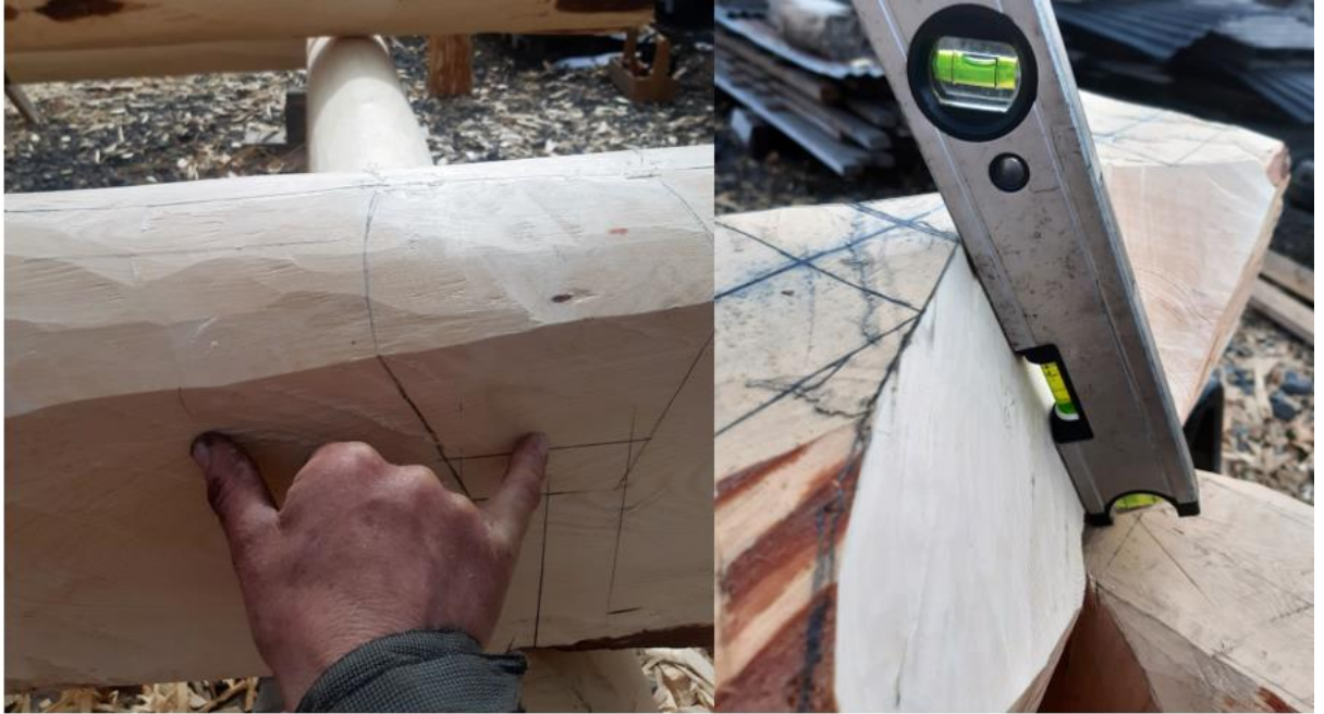
45 og 46. Nytt og gamal målereiskap, handa er fin og måle breida på kinninga med og det justerbare vateret er kjekt når ein skal dokumentere og kontrollere hallinga på kinningene. (foto; Høgnes)
