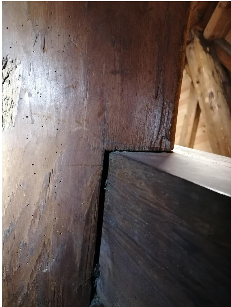
Bilde 19 Merking av sperrehakk med blyant. en av få merkinger i konstruksjonen, Foto: Lars Sonnenrein
