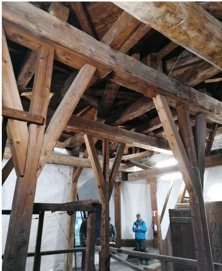
Bilde 7 Bjelkelaget som opprinnelig hadde et frispenn av 9,6m. På et senere tidspunkt ble det støttet av med søyler. Foto. Lars Sonnenrein
