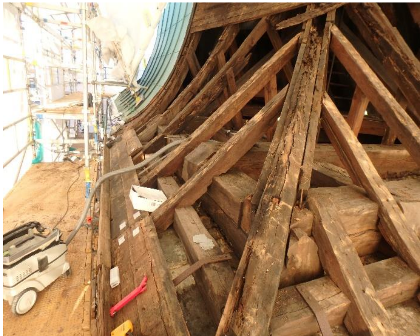
Bilde18 Den originale hjørnekonstruksjonen, Bildet viser hjørne i Sørøst, Foto: Øystein Mortensen
