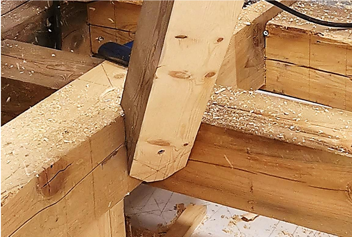
Bilde 58 Hjerteklo, Undergradsperren med hjerteklo som kviler på innersvillen. Det var utfordrende at innersvillene lå i forskjellige høyder. Foto: Helge Kleemann
