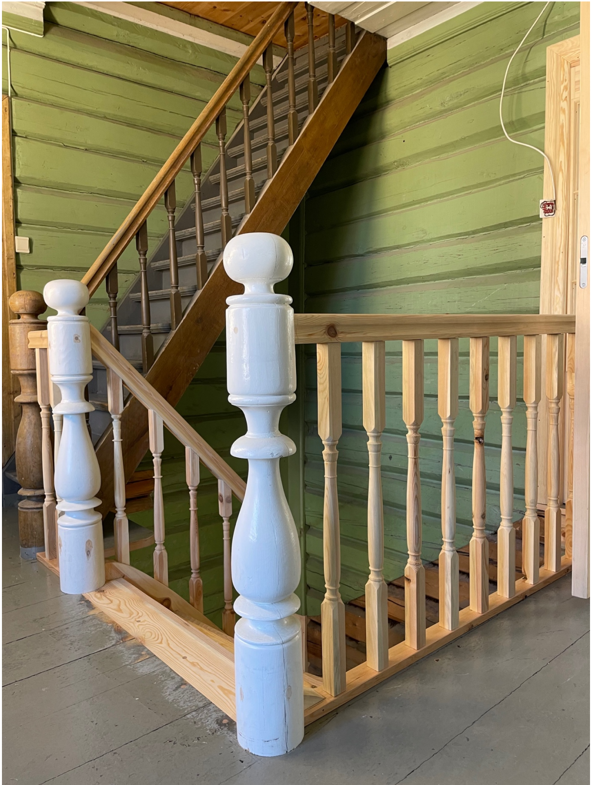
Figur 22. Uttrinn ved trapp i andre etasje.
