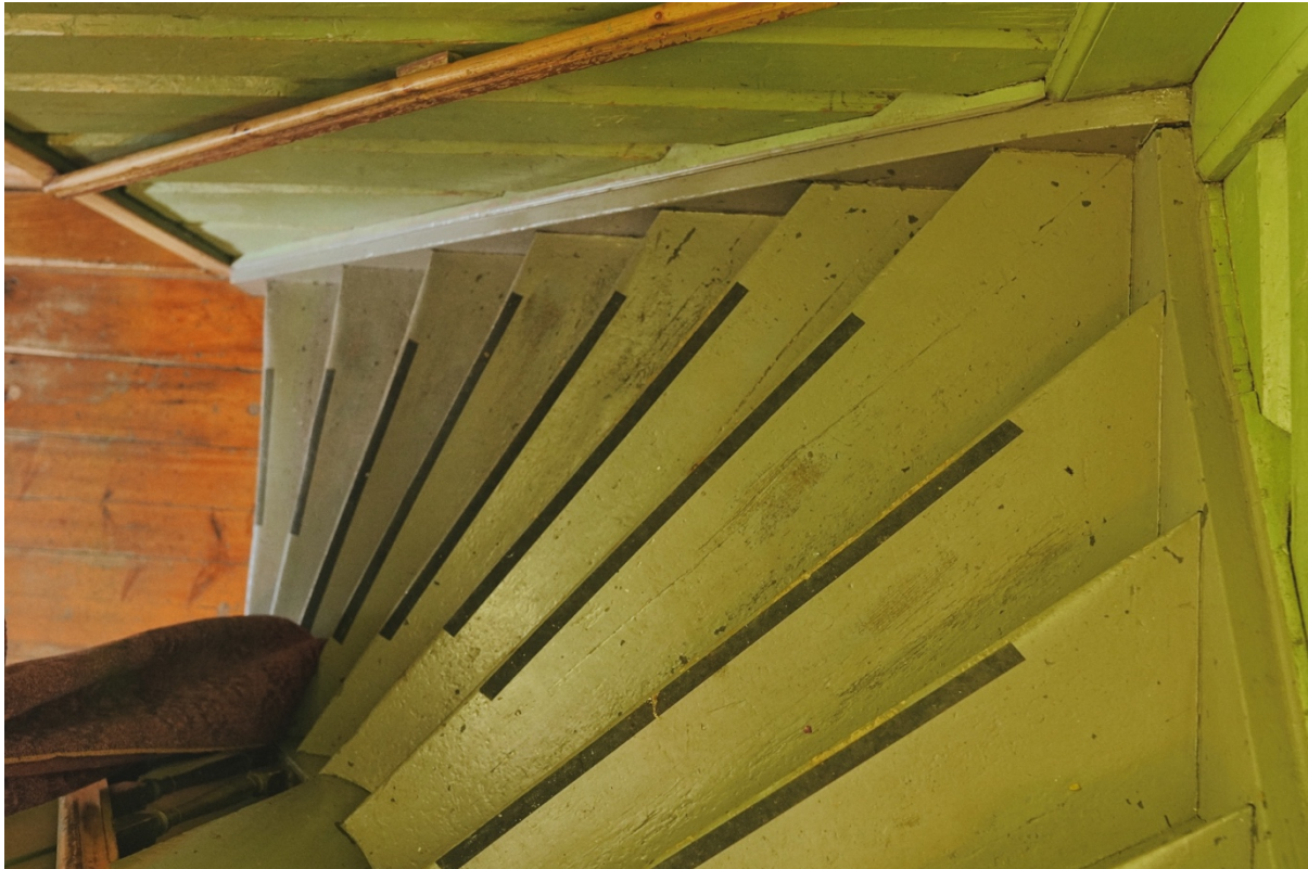
Figur 4. Den gamle trappen sett ovenfra. Her ser vi tydelig breddeforskjellen på inntrinnene i ganglinjen som beskrevet i Figur 3.
