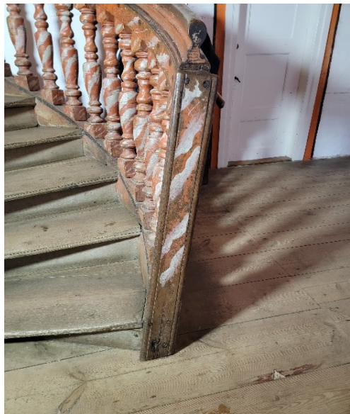
Bilde 10: Gelenderet er mye ut av lodd i begynnelsen av trappen.
