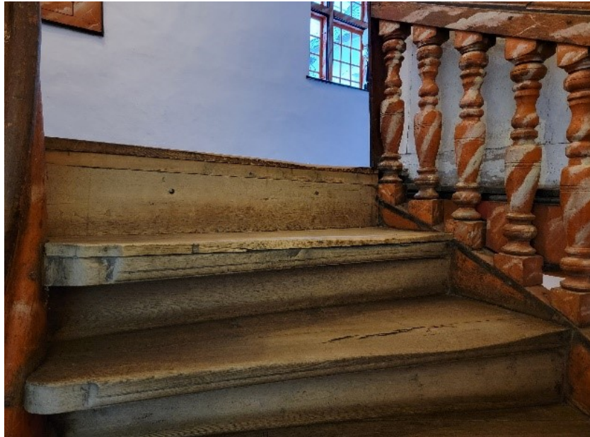
Bilde 8: På de siste to trinnene er det bygget opp med et bord. Dette kan tyde på at gulvet i andre etasje ble forandret på et tidspunkt.
