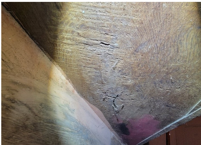
Bilde 9: Sag spor på undersiden av gangtrinnet brydde man seg ikke med å fjerne, selv om undersiden er synlig.
