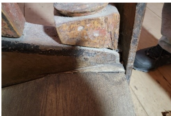
Bilde 5: Trinnet er sklidd ut av vangen. Det er satt inn en kile hvor glipen var for stor. Slike detaljer er vanskelig å fange opp med fotogrammetri. Detaljen er også tidkrevende å dokumentere med tegninger, da tegninger i 1:1 må til. Dette kan ikke leses av på en tegning i målestokk 1:200.
