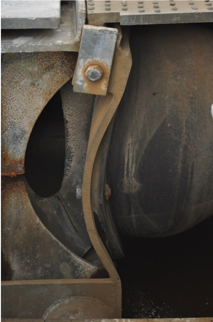
Figur 21 – En tydelig deformasjon i form av knekking på steget. Foto fra inspeksjon.
