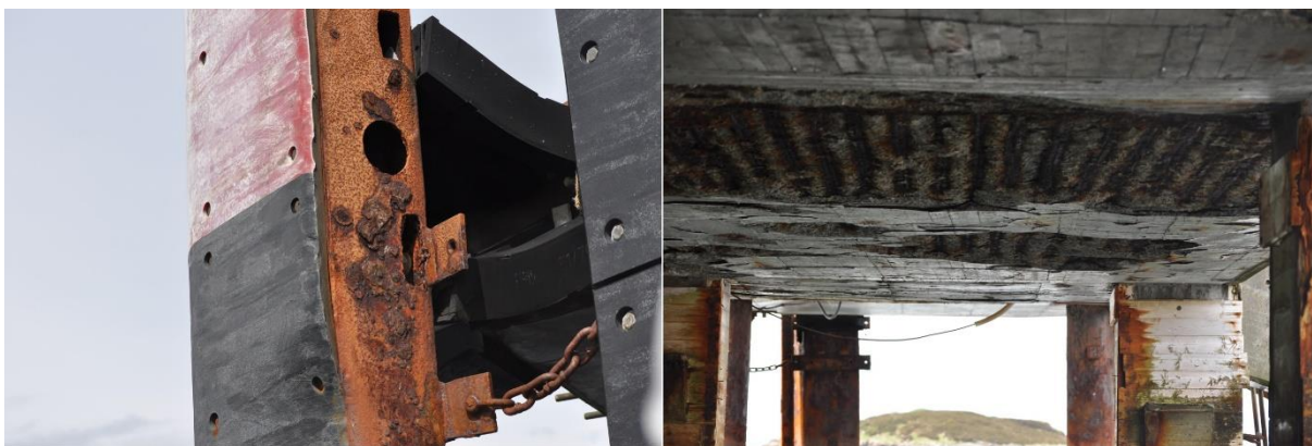
Figur 23 - Småge ferjekai – Venstre: Svært korrodert og gammelt fenderverk.
