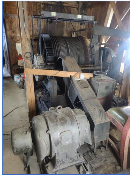
Motorspill til skråsjaktheisen i Olavsgruva. Foto: Simen Flaten Svisdal, 22.02.2022
