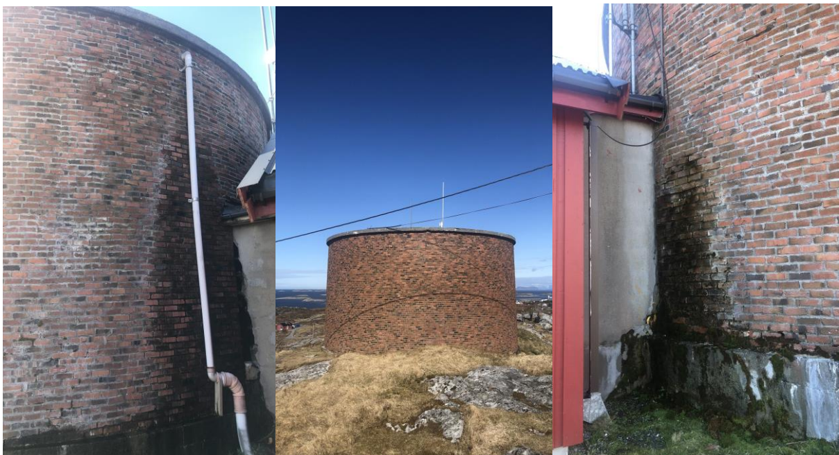
Figur 16: Høydebasseng sett bakfra (midt) og små lekkasje fra sidene
