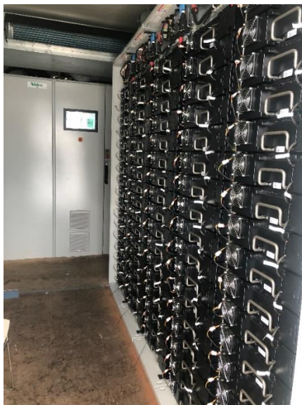
Figur 13 viser batterilagringen ved Remote Prosjekt sitt anlegg på Rye i Trøndelag.
