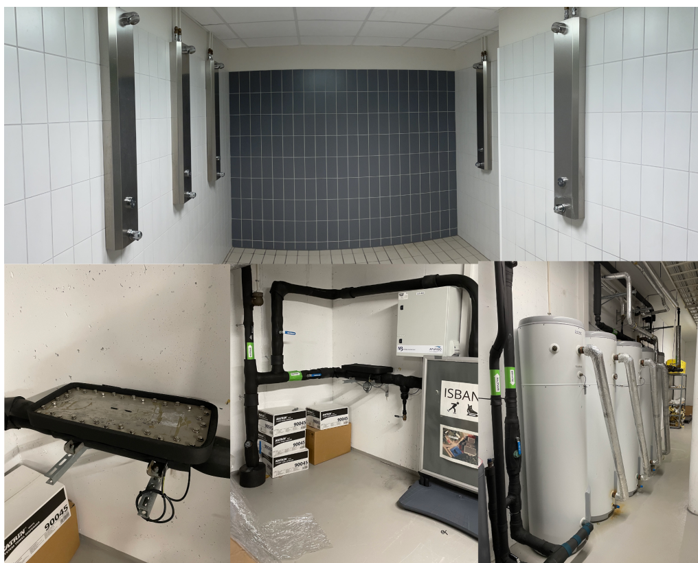
Figur 4.15: Dusjanlegg (svømmehall), Apurgos vannbehandlingssystem, vanninntak og VV-beredere Bygg D
