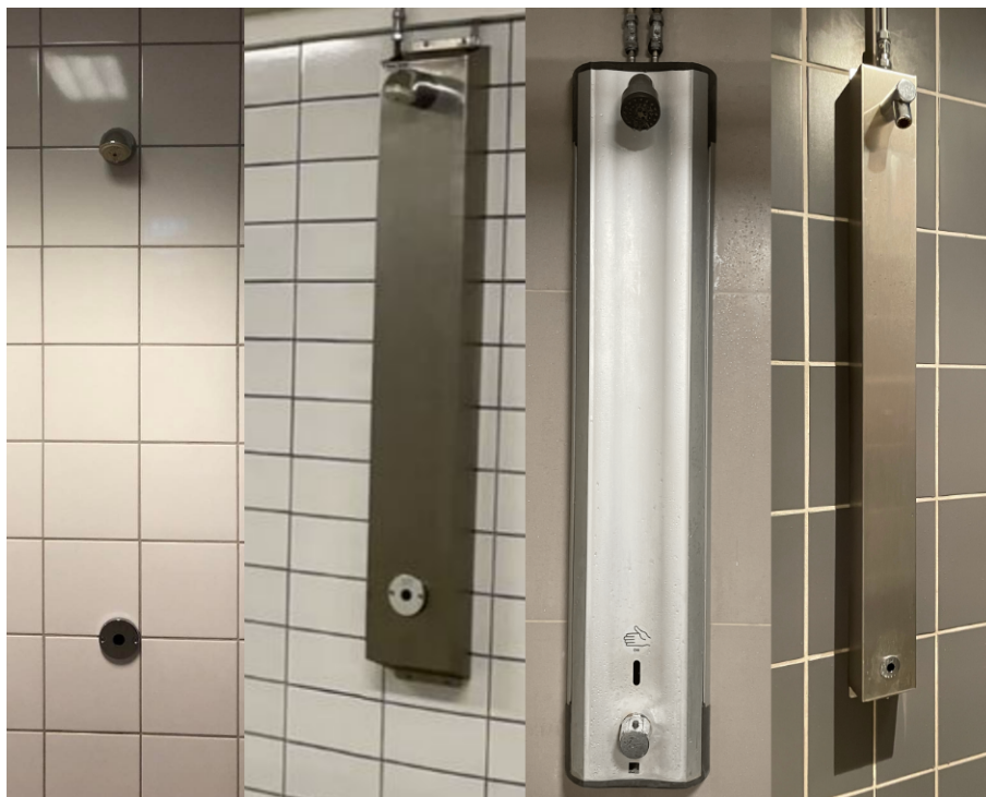
Figur 5.3: Sensorstyrte dusjer Bygg A, B, E og F
