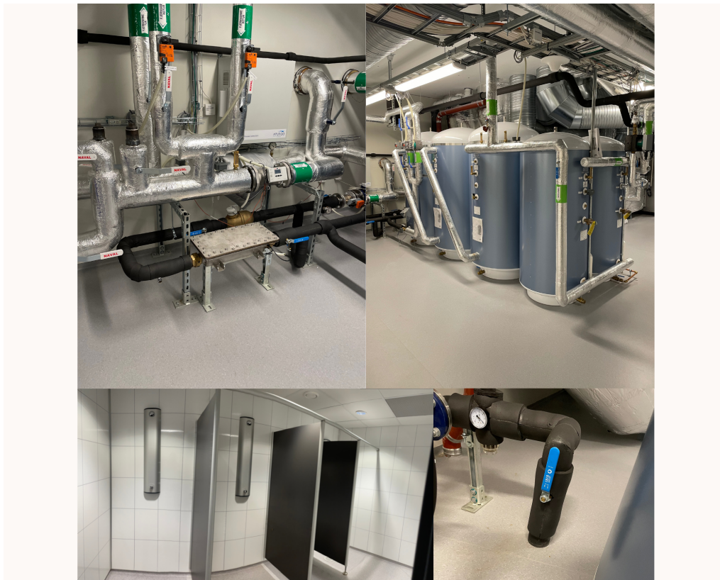
Figur 4.12: Apurgos vannbehandlingssystem, VV-beredere, dusjanlegg og vanninntak Bygg C
