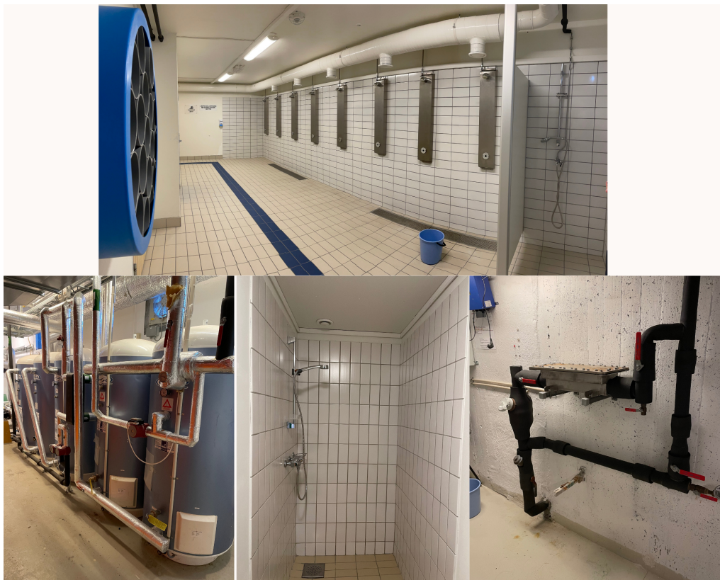
Figur 4.8: Dusjanlegg, VV-beredere, instruktørdusj og Apurgos vannbehandlingssystem med vanninntak Bygg B
