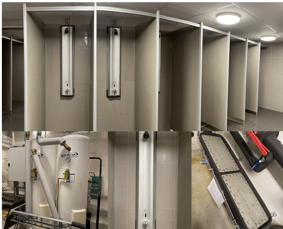
Figur 4.21: Dusjanlegg, VV-beredere, dusjpanel og Apurgos vannbehandlingssystem Bygg E
