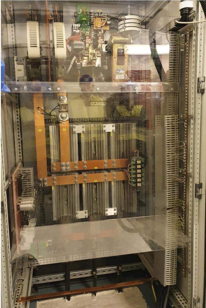
Figur 12 Innsiden av spenningsregulatorskap i Leirfossene vannkraftverk
