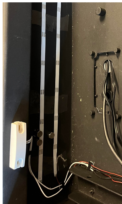
(b) Vanndetektor og magnetkontakt i bunnen av skiltkabinettet
