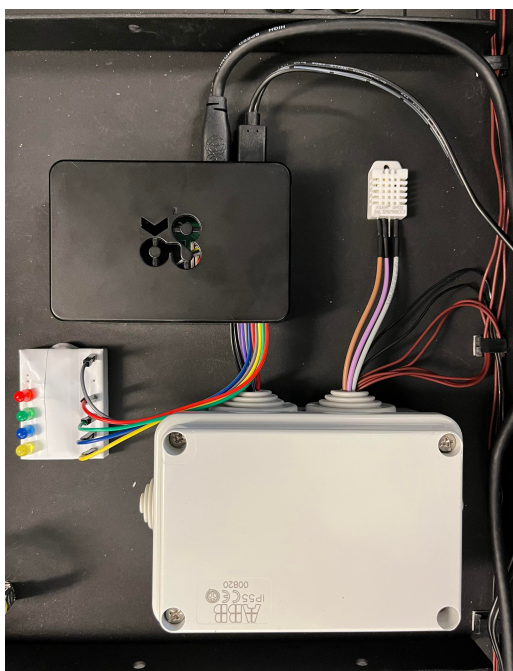
(a) Raspberry Pi, innvendig temp- og fuktssensor, LED-lys og koblingsboks
