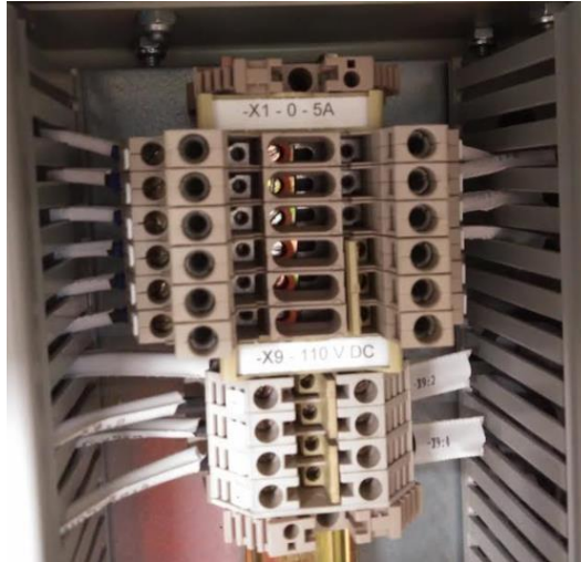
Figur 6-13: Rekkeklemmer i strømtransformatorens sekundærside som blir brukt i Ekofisk-området.
