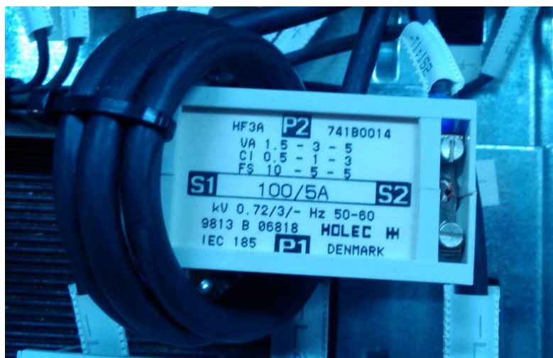
Figur 6-18: Strømtransformator for kraftkrevende starterskuffer.
