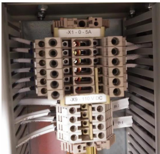
Figur 6-5: Rekkeklemmer i strømtransformatorens sekundærside som blir brukt i Ekofisk-området.
