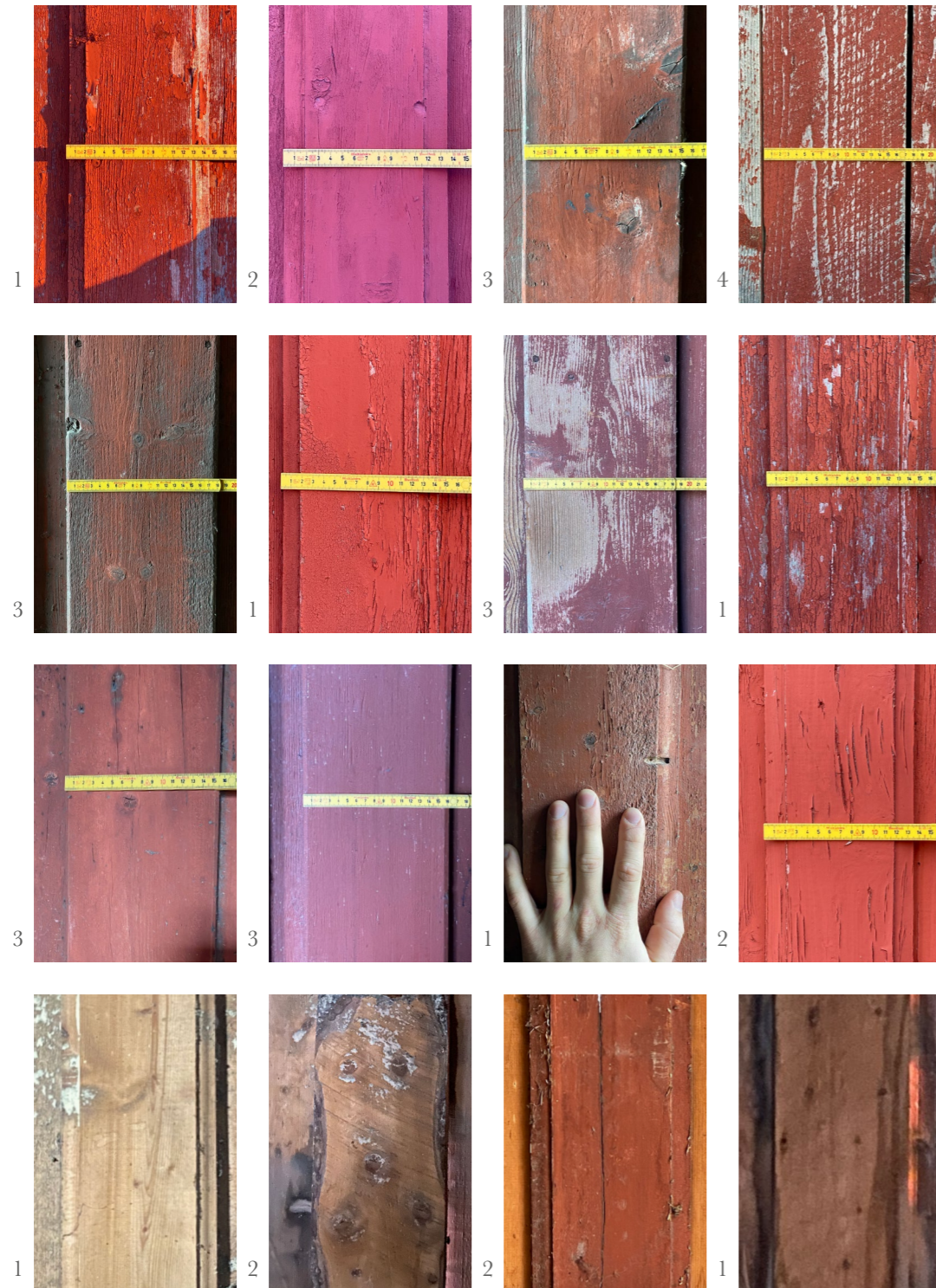
1: Opprinnelig panel fra låven som ble bygget i 1928 2: Nyere panel fra påbygging i 1950 3: Gammelt panel 4: Nytt og dårlig panel på et skur
