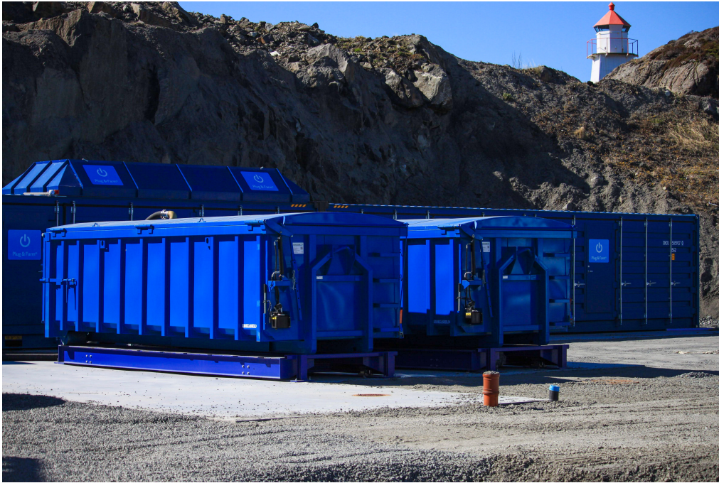
Figur 4.2: Anlegg for behandling av slam. Levert av Blue Ocean technologies..
