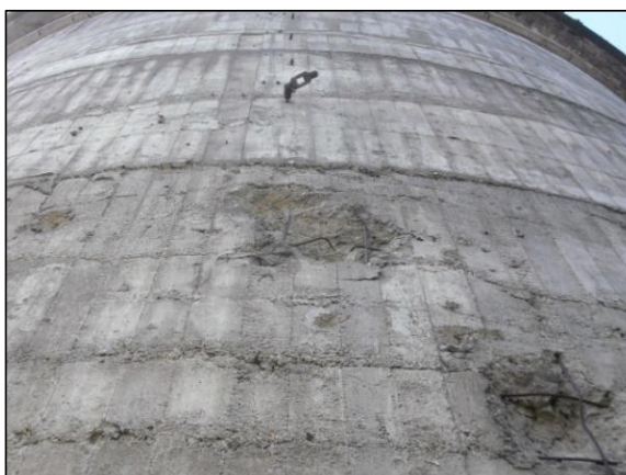
Figur 44: Mulige sprengningsskader i betongveggene på et bunkertårn. Foto: Kristoffer Eliassen Grini
