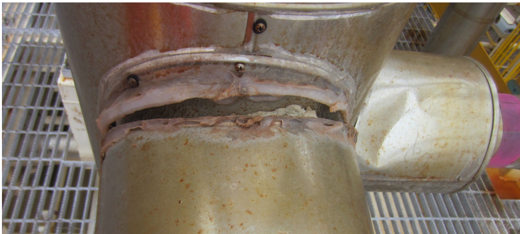
Figur 3.3: En tydelig skadet ytterkapsling der vann og forurensning kan trenge inn til isolasjonen Eddysonics, ud
