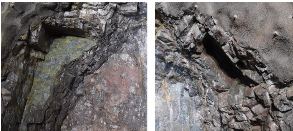
Figur 44: Blokkutfall ved pel.2535-2540 i området med låg overdekning i Bruliheitunnelen.
