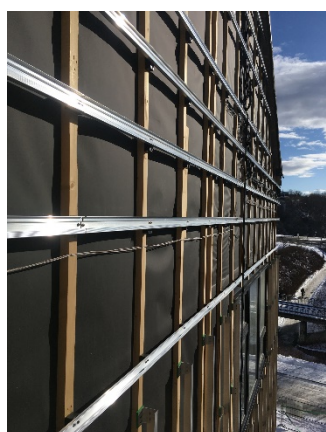
Utlekking av solcellekledning på vestfasade. Øvre del av veggen har BIPV montert på horisontale metallskinner. Nedre del av veggen har dummy-paneler på vertikale metallekter.
