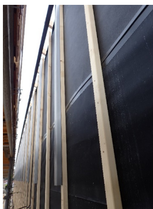
Utlekking bak solcellekledning i toppen av veggen på nordfasade
