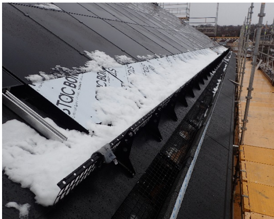
Montering av dummy-panel mellom snøfanger og nederste solcellerekke. Takrenne med rist i underkant av snøfanger
