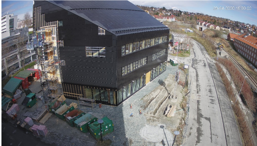
Figur 17. BIPV på taket produserer strøm til drift av byggeheisen, belysning, oppvarming, lading av batterimaskiner og alt annet elektrisk utstyr som var nødvendig for fullføring av ZEB-laboratoriet.
