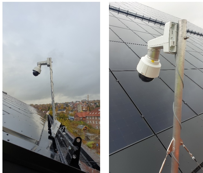
Figur 20. Et kamera på taket av ZEB-laboratoriet gjør det mulig å overvåke for eksempel avrenning og snøforhold på taket. Kameraet blir også brukt til å observere snøras fra taket.
