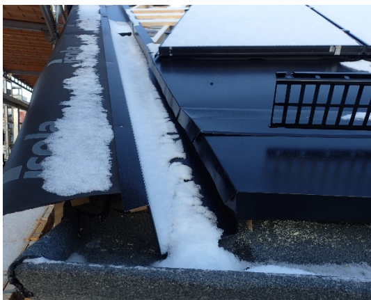
Beslag montert som ekstra fuksikring under dummy-panel ved takfot
