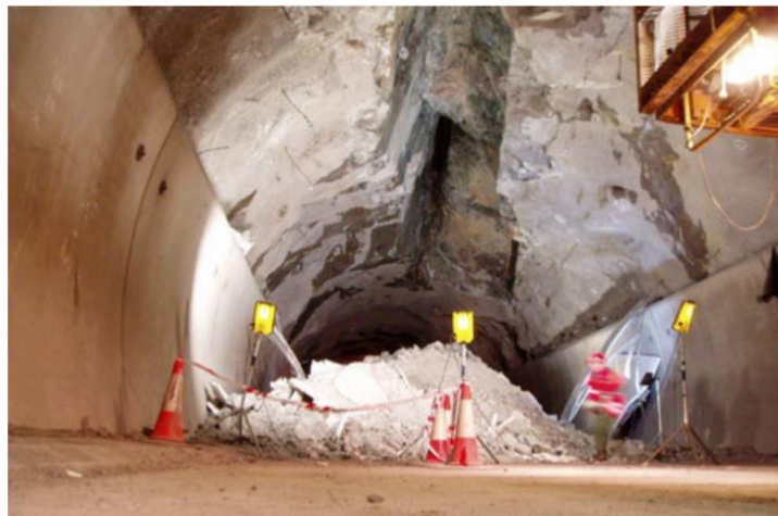
Figur 13 Tunnelkollapsen i Hanekleivtunnelen. Bildet ble tatt 2 uker etter kollapsen i tunnelhengen 1. juledag 2006 (Nilsen, 2011).
