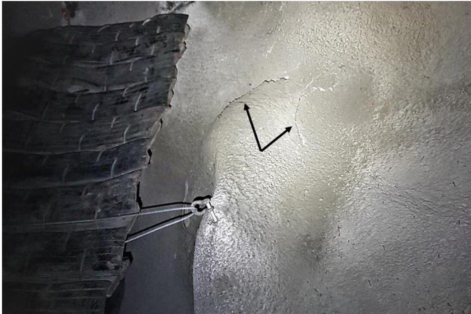
Figur 45 Oppsprekking av sprøytebetongen på bergstappen i koplingssporet.
