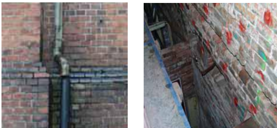
Figur 2.5 Følgeskader på manglende vedlikehold. /E/
