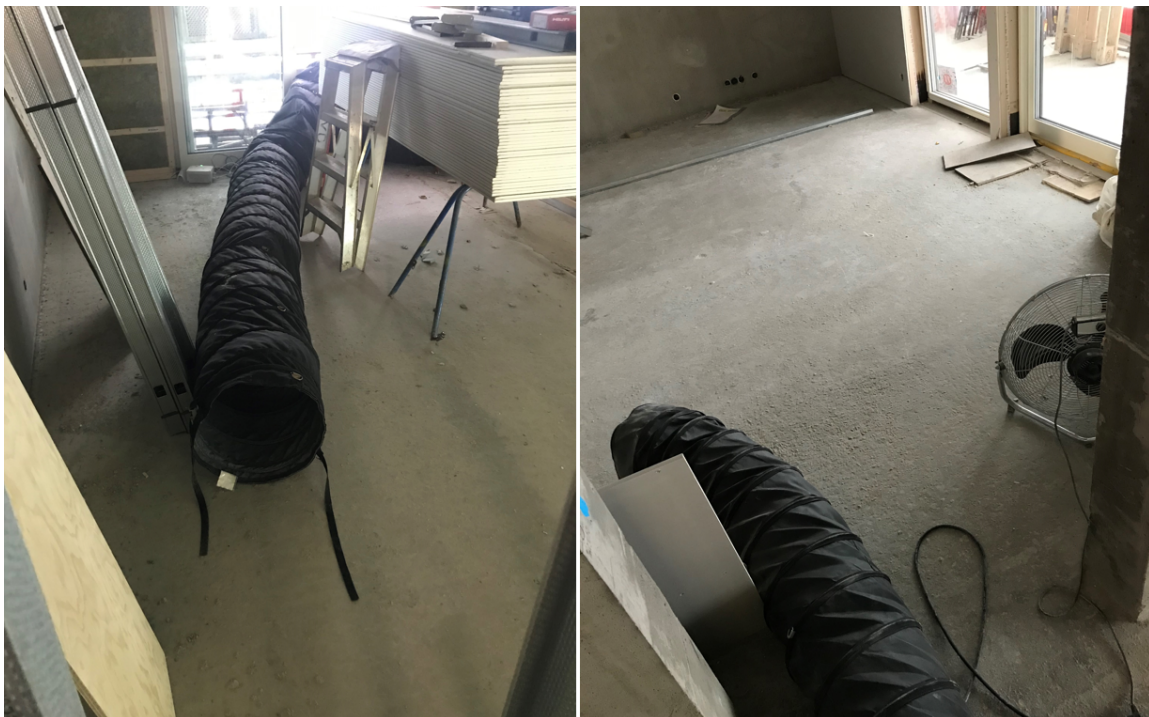
Figur 6.1: Varmeslangene for spredning av varme i bygget (eget bilde).
