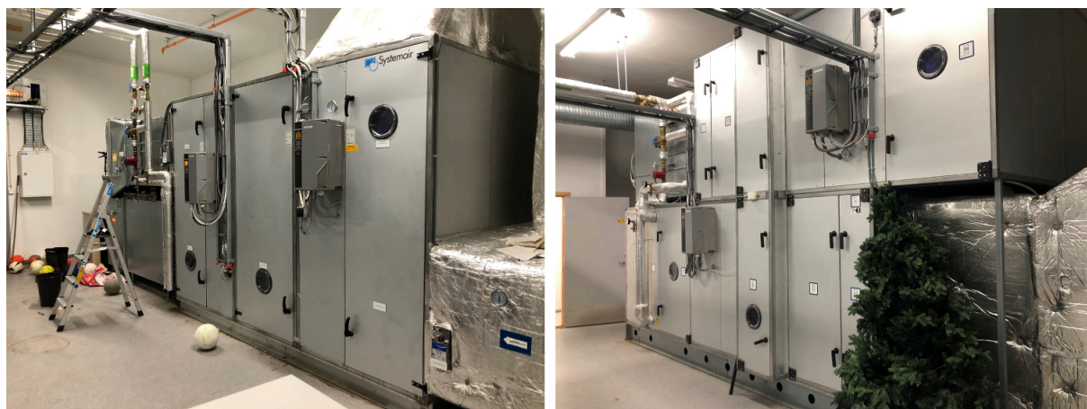
Figur 32: Ventilasjonsaggregatene i hovedbygning på Skole B
