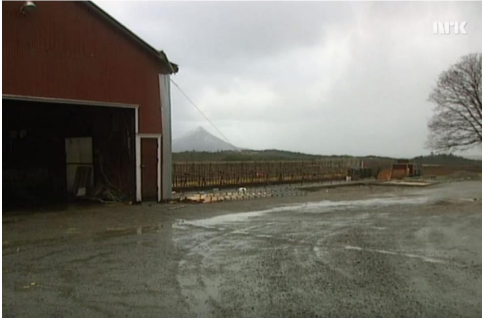
Figur 3: Restene igjen etter driftbygningen til Johan Myrbostad som blåste av murene i Elnesvågen. Kilde: Skjermdump fra NRK-programmet «Nyttårsorkanen 1992».
