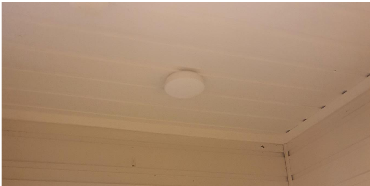
Figur 11: Måler plassert i taket, Case B.
