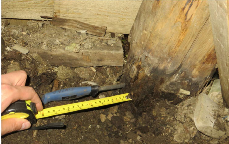
Figur 3-10. Råte på pel [3].
