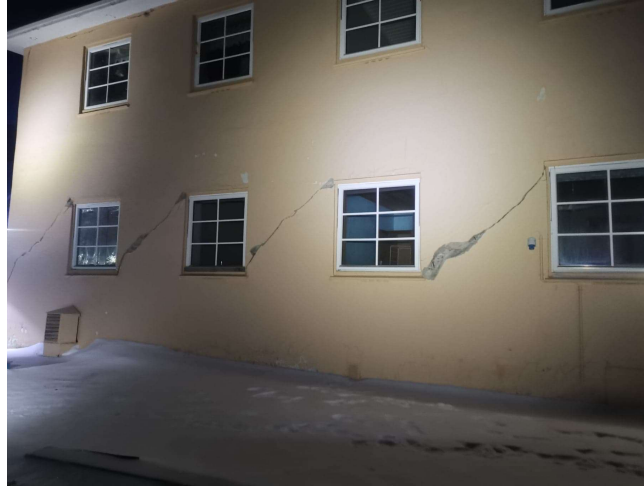
Figur 3-2. Setningskader på det gamle sykehuset i Longyearbyen, foto: CR.
