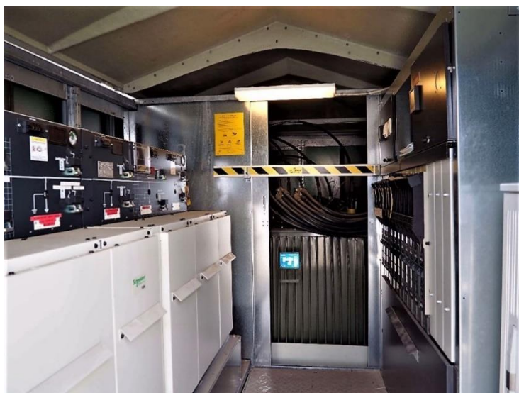
Figur 7: Innvendig betjent nettstasjon [20]
