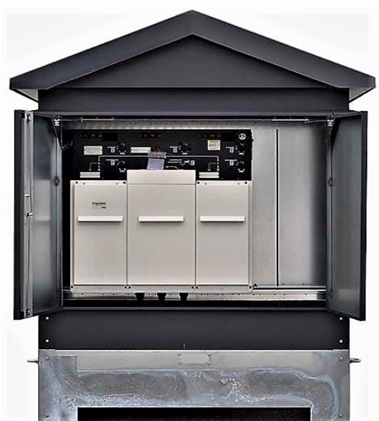
Figur 5 : Utvendig betjent nettstasjon [19]
