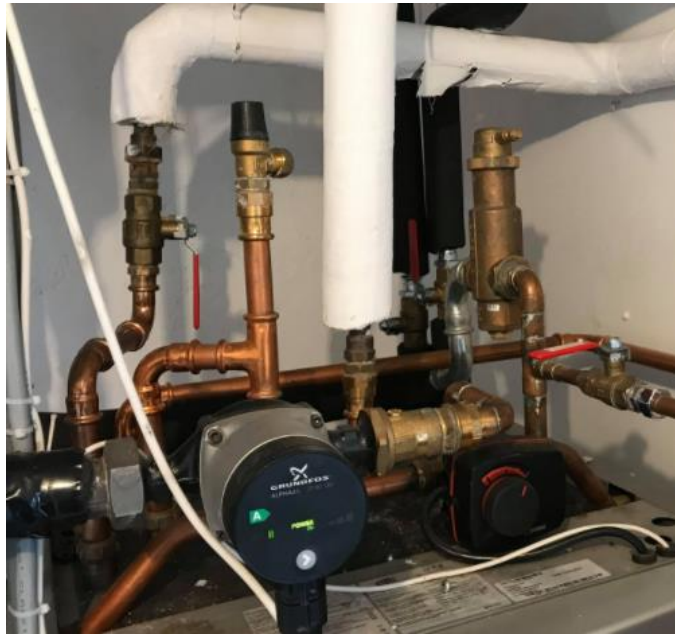
Figur 12, Installert EcoEl Topp med rør
