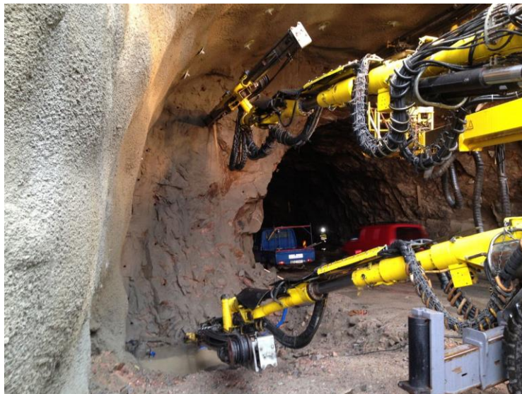
Figur 5.9: Boring av salvehull i Mjåvannstunnelen samtidig som trafikk passerer. Arbeidet måtte stoppe opp mens kolonnen passerte (Birkeland, 2020).
