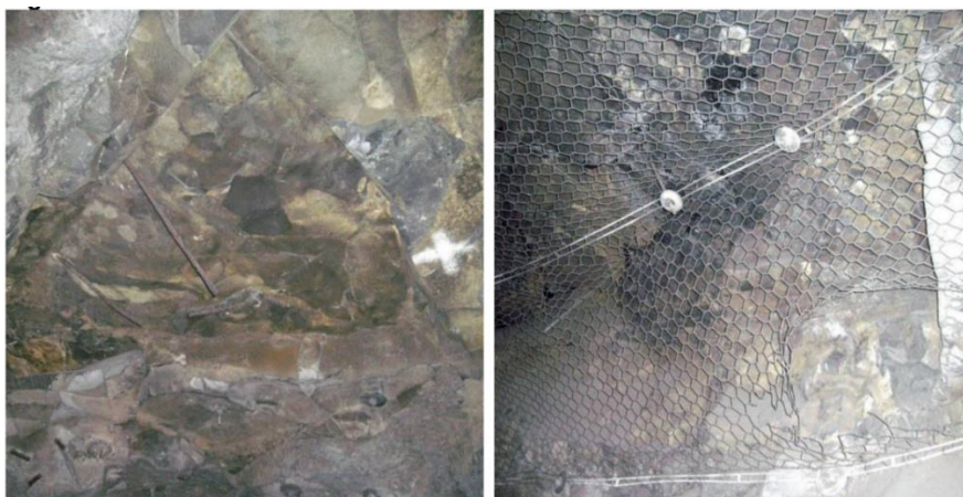
Figur 6.4: Foto fra tunnelinspeksjon ved pel 300 i Árnafjarðartunnilin som viser område med utfall i hengen, som i dag er sikret med netting og bolter (Salomonson & Thorsager, 2007).
