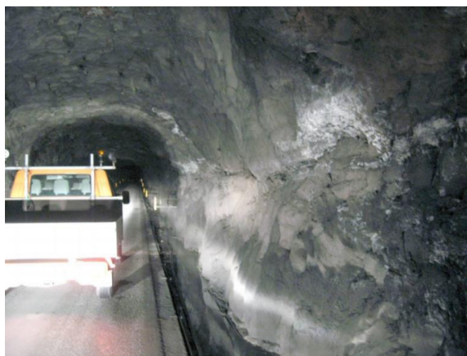
Figur 6.5: Foto av vegg ved pel 950 i Hvannasundstunnilin der det tidligere har vært utfall på 1 \text{ m}^3 på grunn av ugunstig sprekkegeometri (Salomonson & Thorsager, 2007). Under inspeksjonen var det markert for bolter, men som fortsatt ikke var installert.
