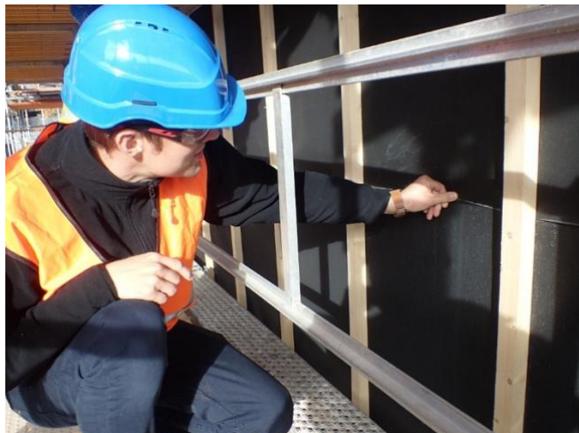
Limt skjøt av UV-bestendig vindsperrereduk uten bruk av klemming i tillegg. Slike løsninger stiller strenge krav til utførelsen og limets bestandighet over tid for at skjøten skal bli varig tett. Foto: Tore Kvande.
