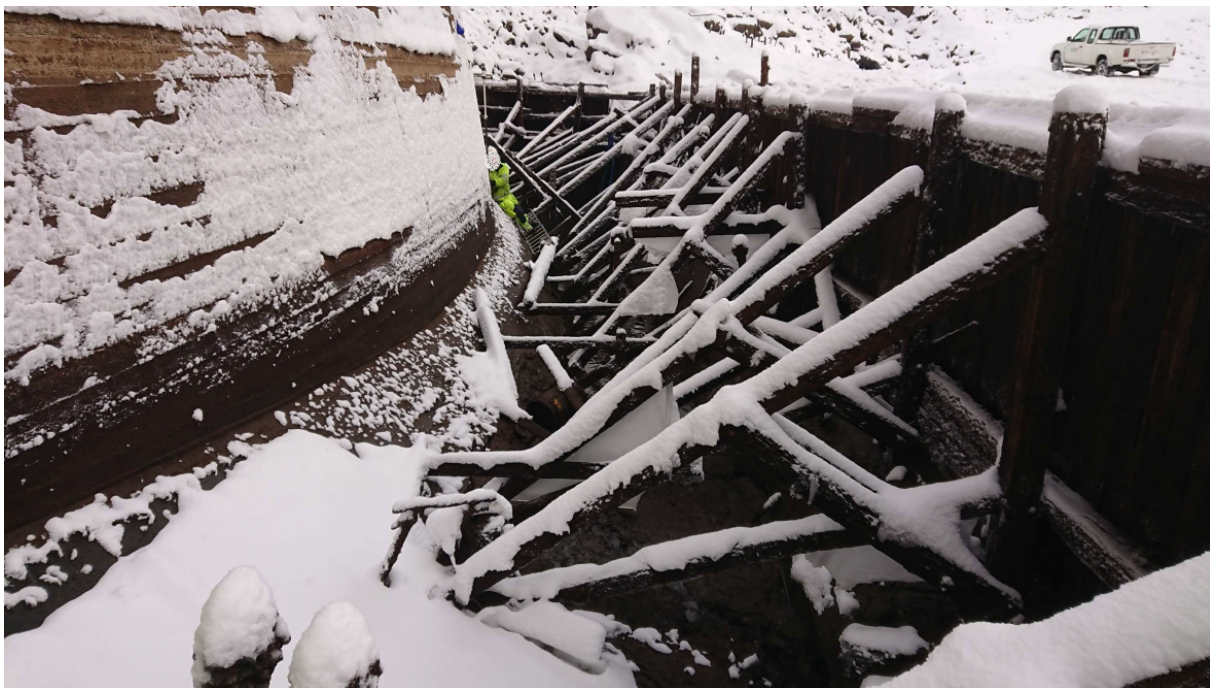
Figur 3.13: Bilete av overgangen mellom kvelv og fundament på oppstraums side. Personen på biletet lenar seg mot ein skråvegg som markerer overgangen.
