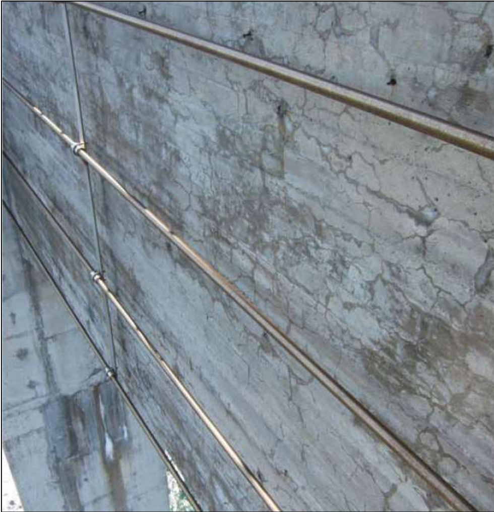
Figur 4-6 Rissdannelser i topprigel i vestre brutårn. [26]
