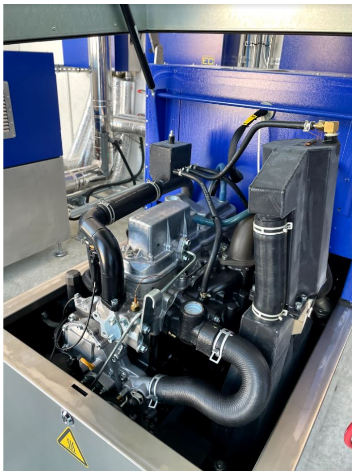
Figur 3.2: En av XRGI 20-motorene, som en del av en CHP-maskin, installert ved Heimdal vgs. Bildet er tatt av Gunhild Lund Bjørnås.
