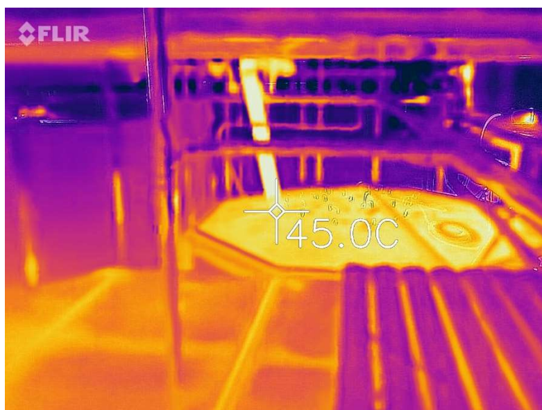
Foto 3 Termisk foto av dampbadet uten isolasjon. Har samme temperatur på innsiden som utsiden.
