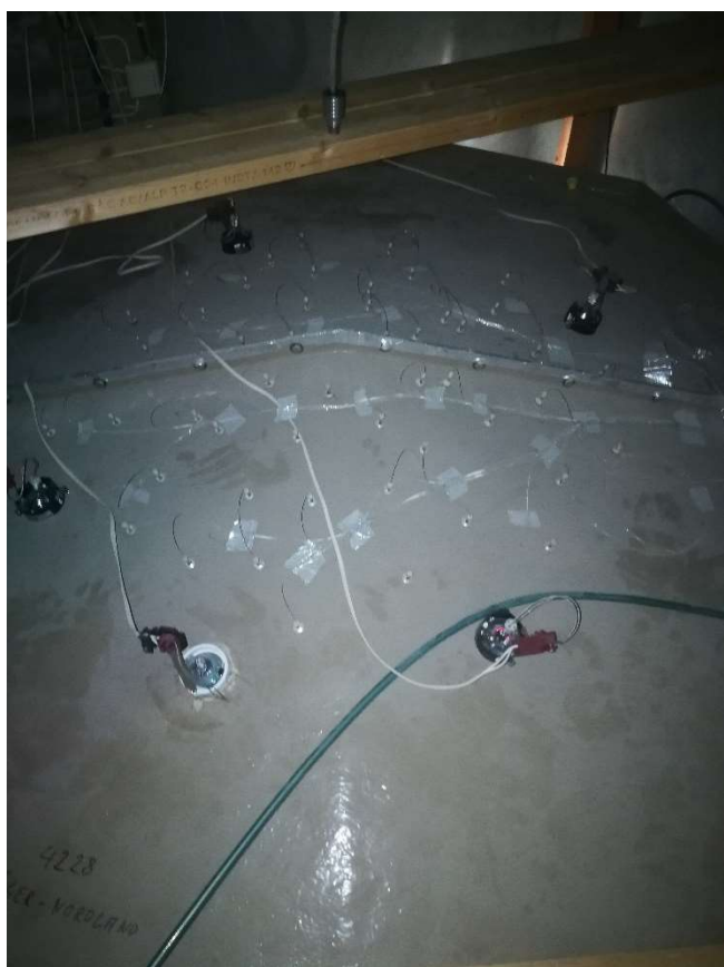
Foto 1 Bilde tatt av taket dampbadet, ingen isolasjon
