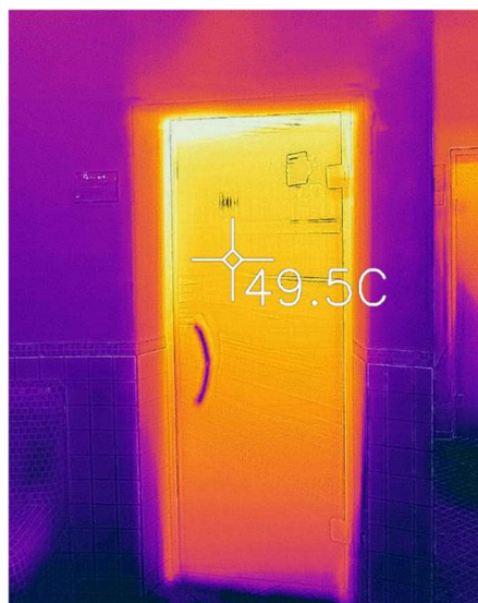
Bilde 14 termisk bilde av glassdøren til Finsk sauna, tatt fra utsiden
