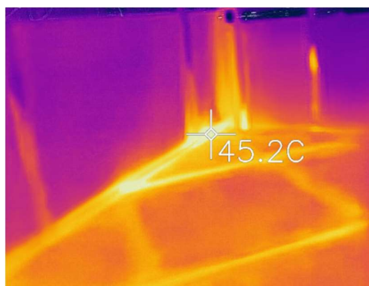
Bilde 21 Termisk bilde av taket rett over badstuoovnen fra utsiden
