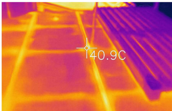
Bilde 20 Termisk bilde av taket til finsk sauna fra utsiden
