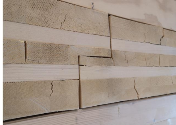
Figur 3: Sprekker i KLT fra trapperom Moholt 50/50
