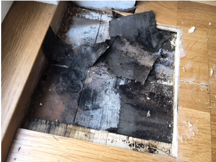
Figur 4.8: Bilde av fuktskade i PH2. Både spon og parkett er fuktig og misfarget.
