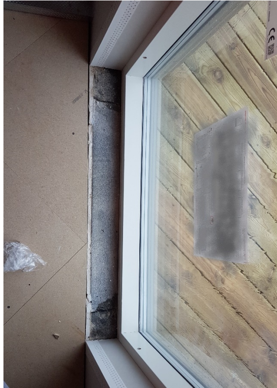
Figur 4.6: Bilde av fuktskade (2). Fukt i begge hjørner.
