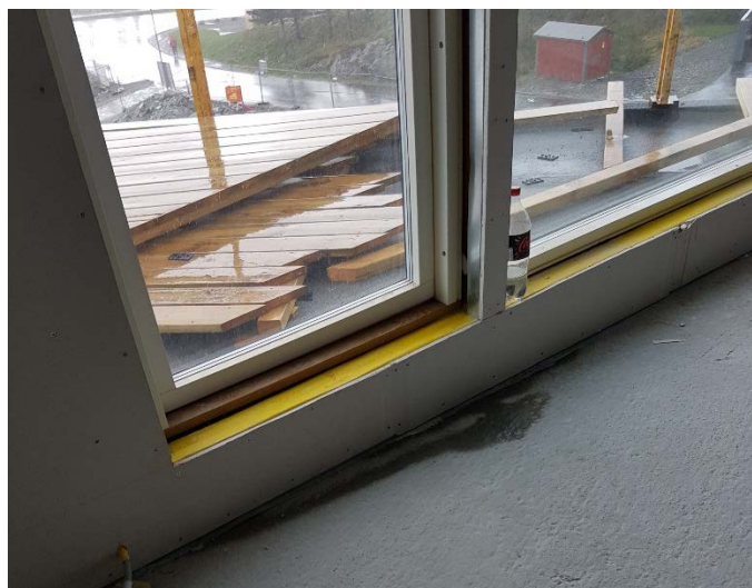
Figur 4.5: Bilde av fuktskade. Fukt på betonggulv.
