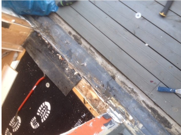
Figur 4.21: Bilde av fuktskaden under utbedring.
