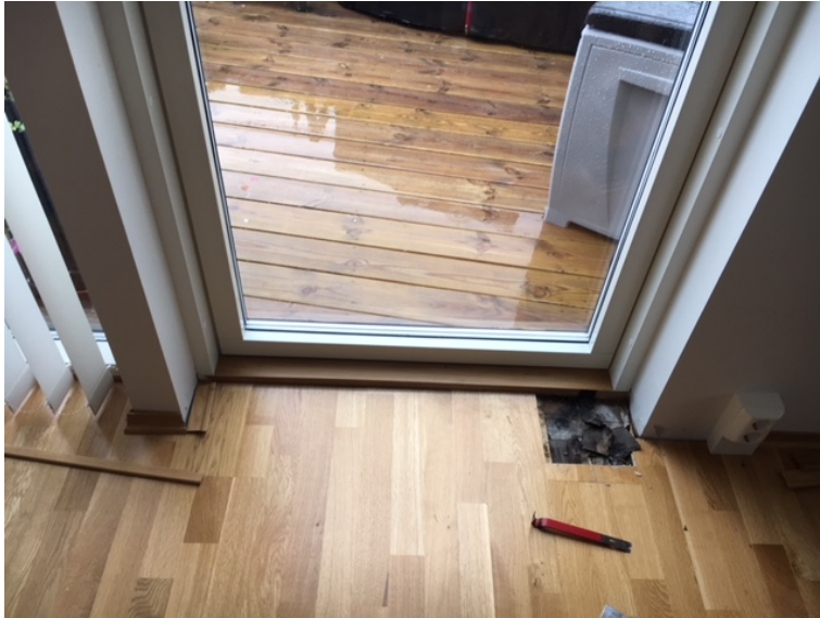
Figur 4.9: Bilde av fuktskade i PH2 (2). Viser hjørnet hvor det var mest skader.
