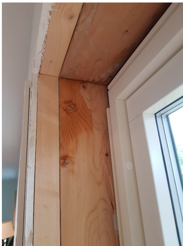
Figur 4.15: Bilde fra vindu i leiligheten under, som viser fukt etter at foring er fjernet
