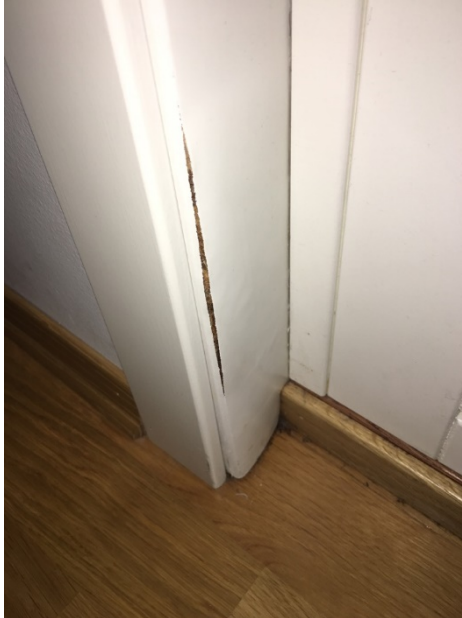
Figur 4.25: Bilde av fuktskaden før nærmere undersøkelse.
