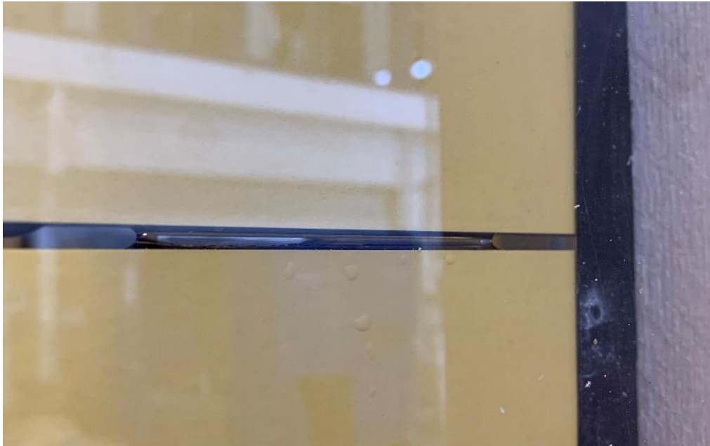
Figur 45 Vannansamling i fugespalte på 3 mm, HPL.
