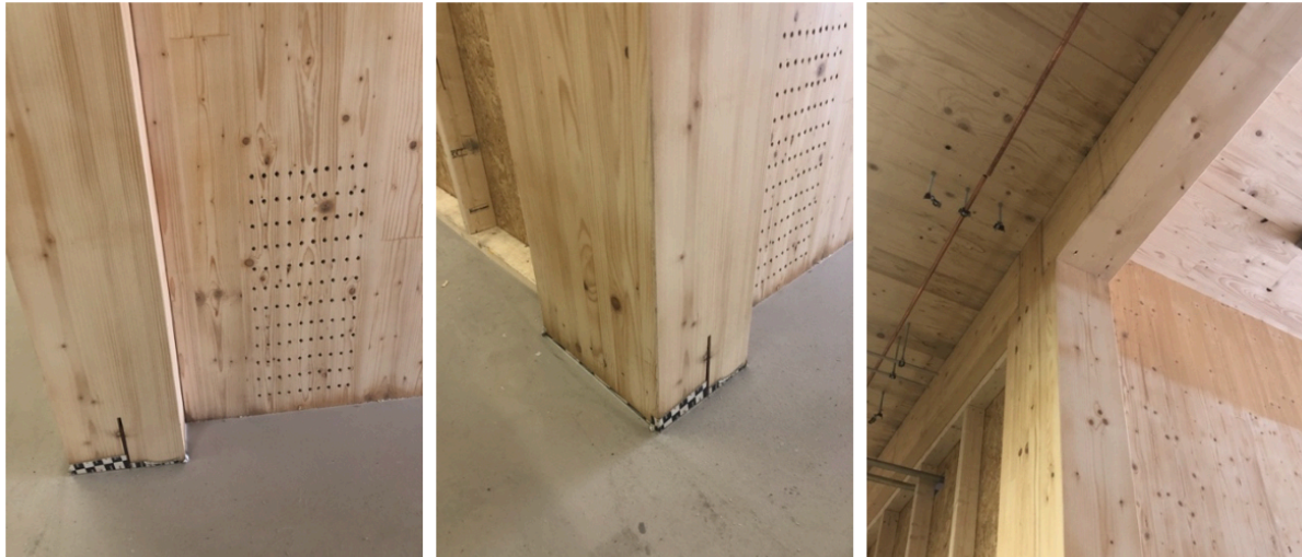
Figur 14 - Slisset spor til festebrakett i limtresøyle (t.v. og m), samt bjelkekonstruksjon oppå søylen (t.h.) (Foto: Rasmus T. Vengen)
