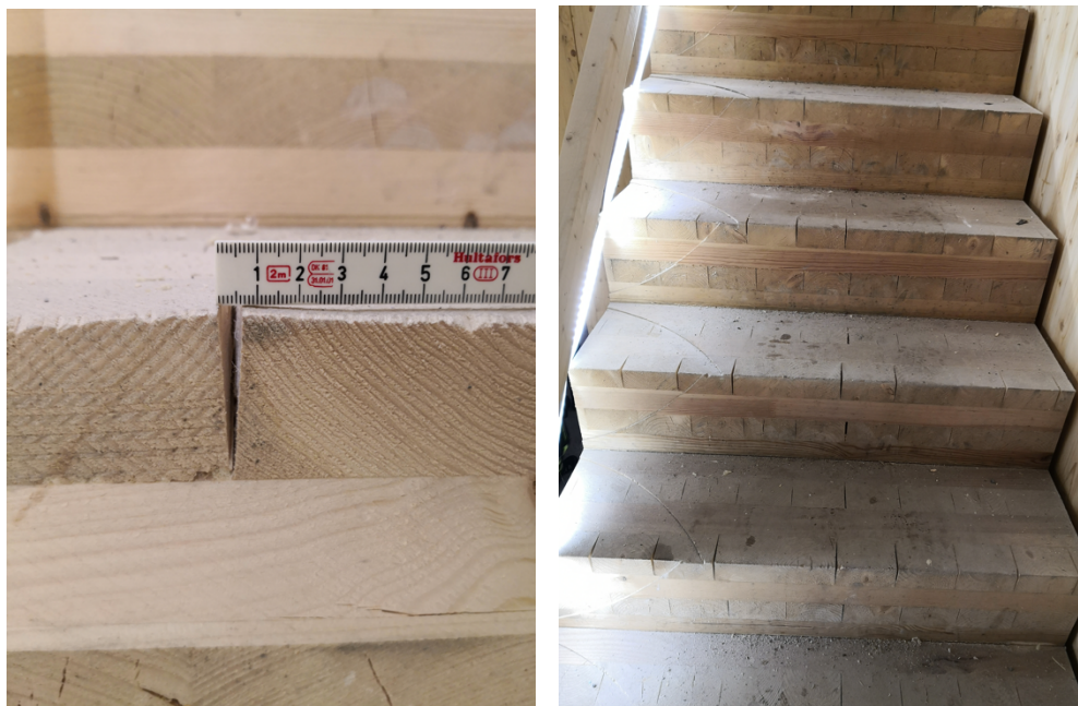
Figur 16 - Sprekkdannelse i trappesjakt (Foto: Rune Kruse Måløy)
