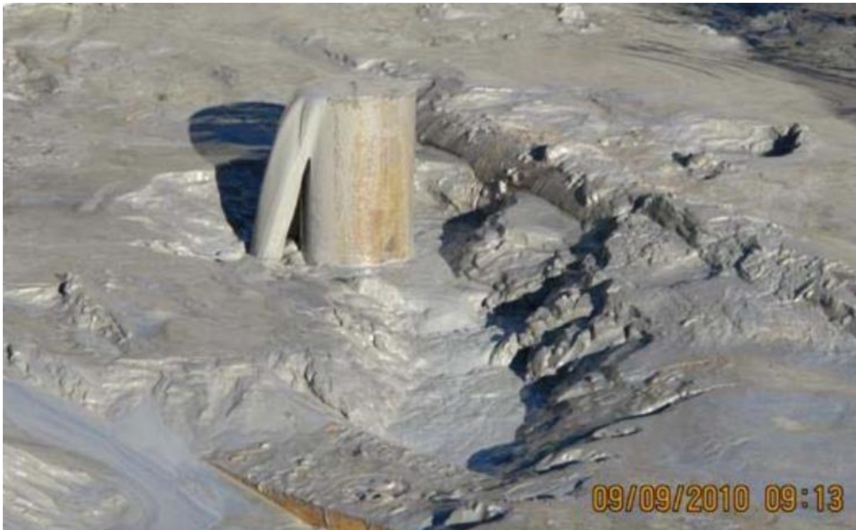
Figur 2: Lekkasje ut fra foringsrør på grunn av artesiske poretrykk. Hentet fra (Gundersen og Dolva, 2010).
