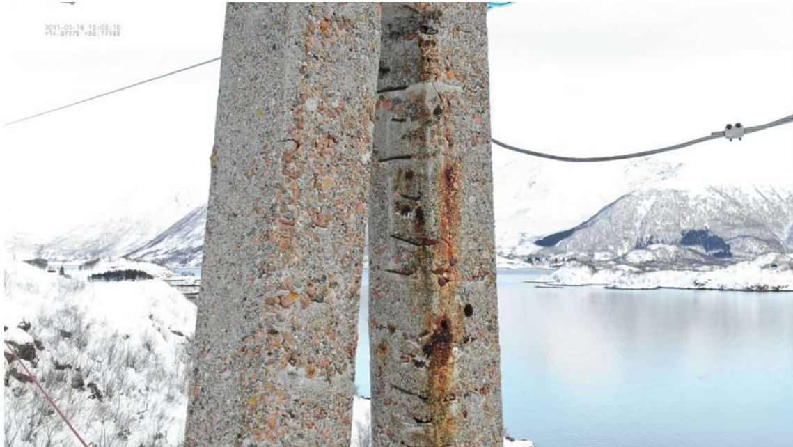
Figur 4.1: Synlig armering i betongmast
