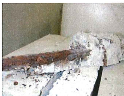
Figur 1 korrosjonsskade på armering som følge av kloridinntrengningene (Bildet er hentet fra Norut)
